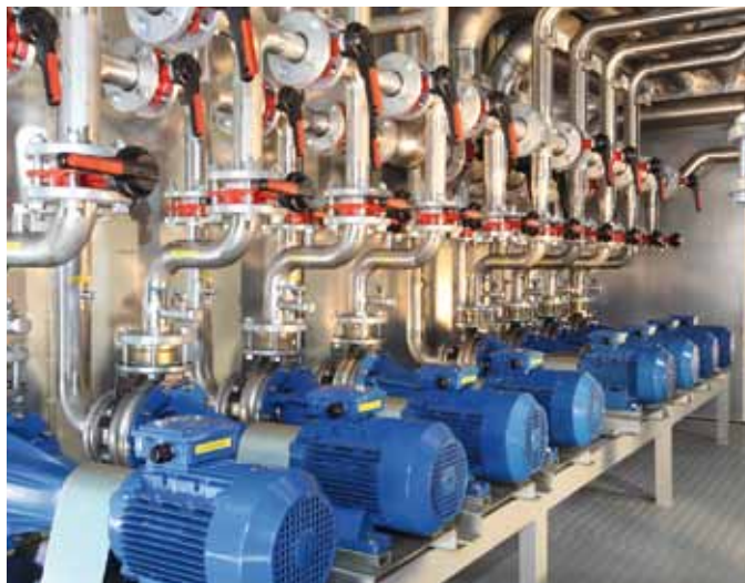
Förderpumpen für ADF und Wasser
