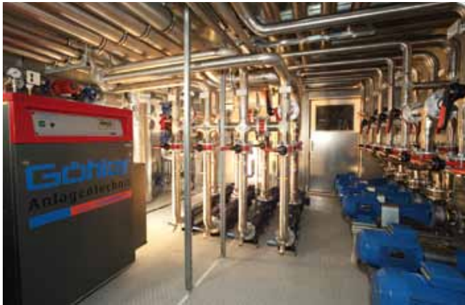
Heizsystem mit Fernwärmekopplung
